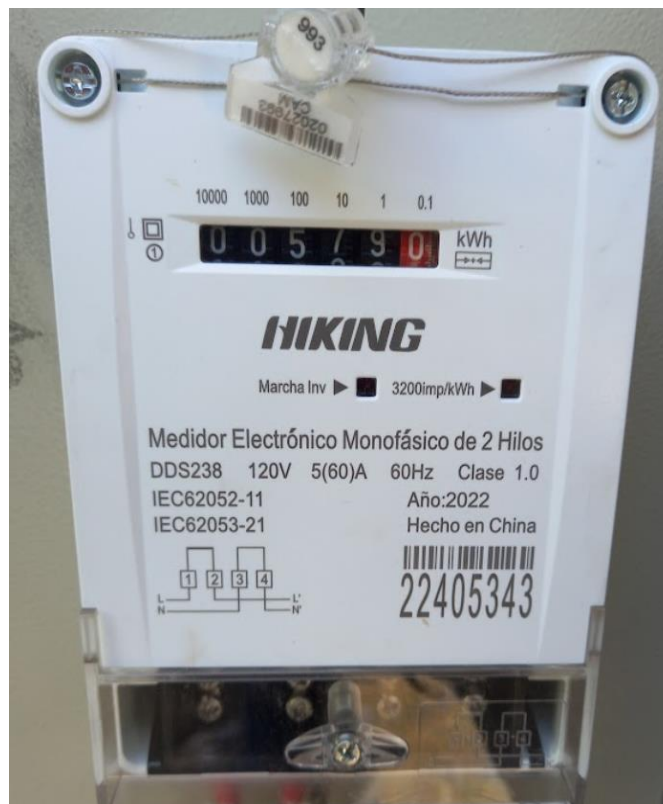
Foto No 2. Medidor No. 22405343 encontrado en terreno instalado y energizado sin encontrarse registrado en el sistema comercial de la compañía con una lectura acumulada de 579 kWh.
