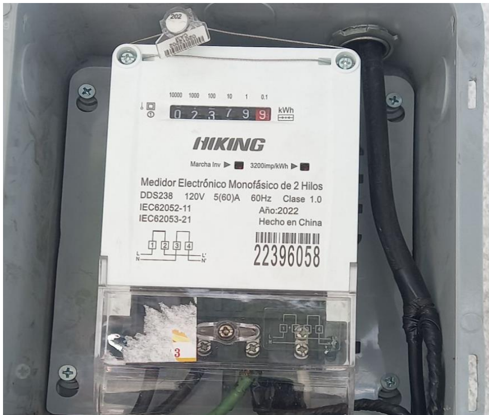
Foto No 2. Medidor No 22396058 encontrado en terreno instalado y energizado sin encontrarse registrado en el sistema comercial de la compañía con una lectura acumulada de 2379 kWh, de los cuales ya se han cobrado 2112 kWh (acta 4307361740 del 03 de enero de 2024) y se encuentran pendientes por cobrar 267 kWh.
