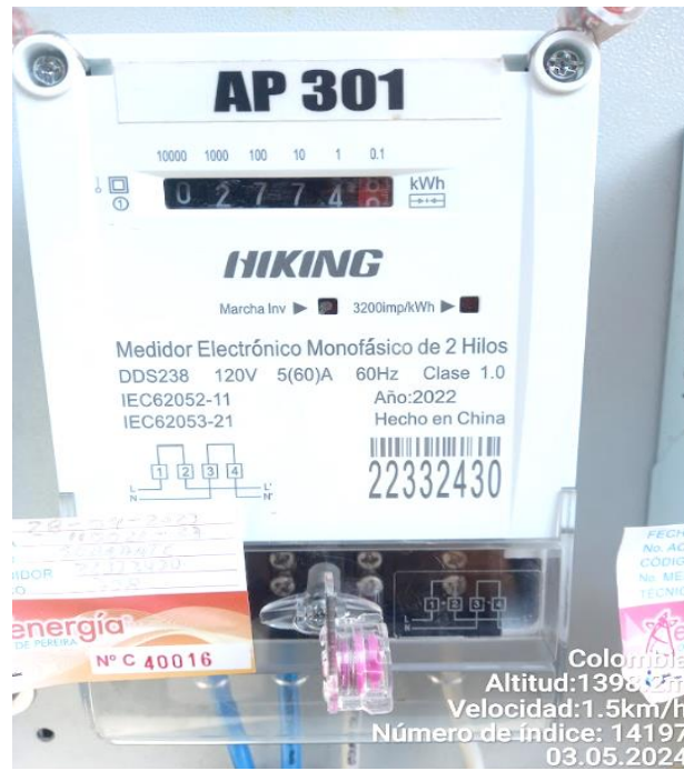
Foto No 7. Medidor No. 22332430 encontrado en terreno instalado y energizado sin encontrarse registrado en el sistema comercial de la compañía con una lectura acumulada de 2776.2 kWh, de los cuales ya se han cobrado 1338 kWh (acta 110030 del 28 de septiembre de 2023) y 758.3 kWh (acta 3014853871 del 19 de diciembre de 2023). Se encuentran pendientes por cobrar 679.9 kWh.
