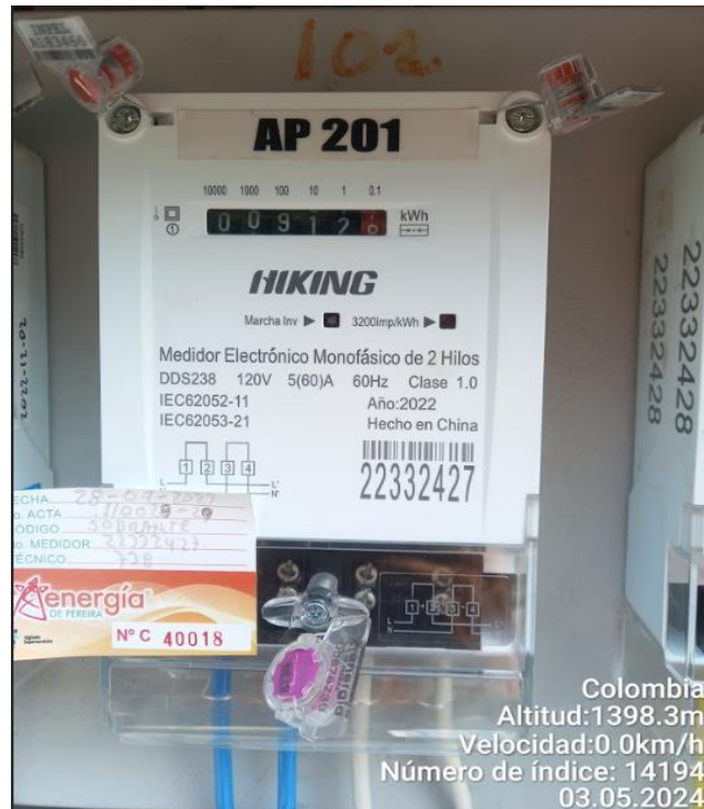
Foto No 4. Medidor No. 22332427 encontrado en terreno instalado y energizado sin encontrarse registrado en el sistema comercial de la compañía con una lectura acumulada de 912.8 kWh, de los cuales ya se han cobrado 446.5 kWh (acta 110030 del 28 de septiembre de 2023) y 249.3 kWh (acta 3014853871 del 19 de diciembre de 2023). Se encuentran pendientes por cobrar 217 kWh.
