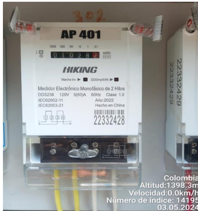
Foto No 5. Medidor No. 22332428 encontrado en terreno instalado y energizado sin encontrarse registrado en el sistema comercial de la compañía con una lectura acumulada de 1028 kWh, de los cuales ya se han cobrado 691.5 kWh (acta 3014853871 del 19 de diciembre de 2023) y se encuentran pendientes por cobrar 336.5 kWh.
