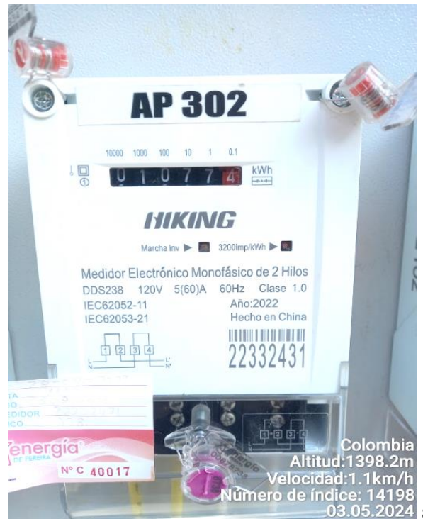
Foto No 8. Medidor No. 22332431 encontrado en terreno instalado y energizado sin encontrarse registrado en el sistema comercial de la compañía con una lectura acumulada de 1077.5 kWh, de los cuales ya se han cobrado 577 kWh (acta 110030 del 28 de septiembre de 2023) y 303.8 kWh (acta 3014853871 del 19 de diciembre de 2023). Se encuentran pendientes por cobrar 196.7 kWh.
