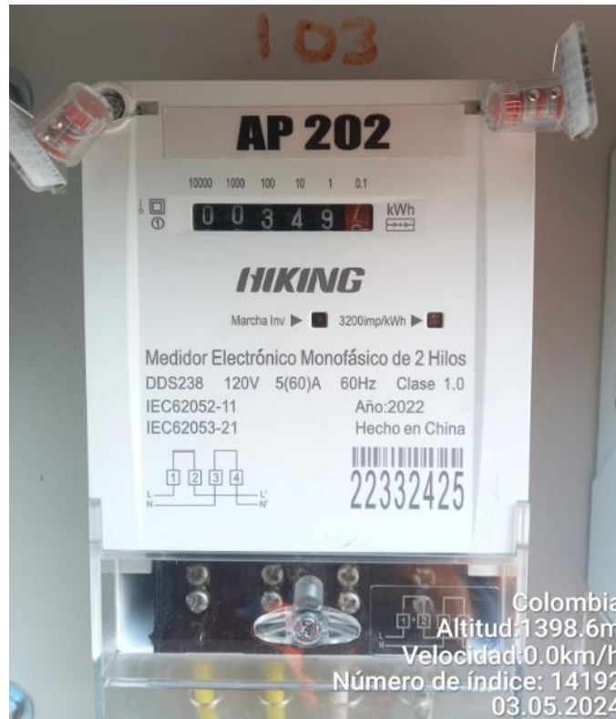
Foto No 2. Medidor No. 22332425 encontrado en terreno instalado y energizado sin encontrarse registrado en el sistema comercial de la compañía con una lectura acumulada de 349.9 kWh, de los cuales ya se han cobrado 78.8 kWh (acta 3014853871 del 19 de diciembre de 2023) y se encuentran pendientes por cobrar 271.1 kWh.
