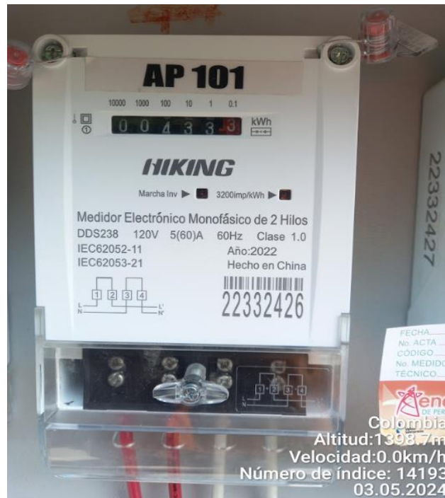
Foto No 3. Medidor No. 22332426 encontrado en terreno instalado y energizado sin encontrarse registrado en el sistema comercial de la compañía con una lectura acumulada de 433.7 kWh, de los cuales ya se han cobrado 232.2 kWh (acta 3014853871 del 19 de diciembre de 2023) y se encuentran pendientes por cobrar 201.5 kWh.
